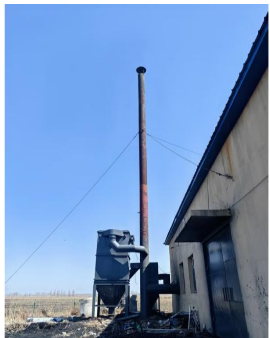
现有除尘器+排气筒
